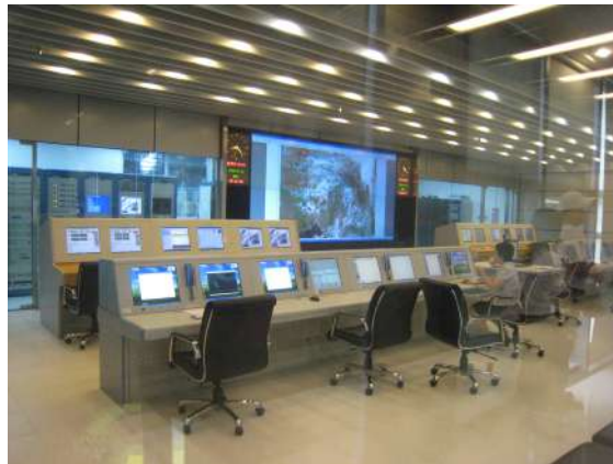
(圖七：氣象地面衛星站控制室)
